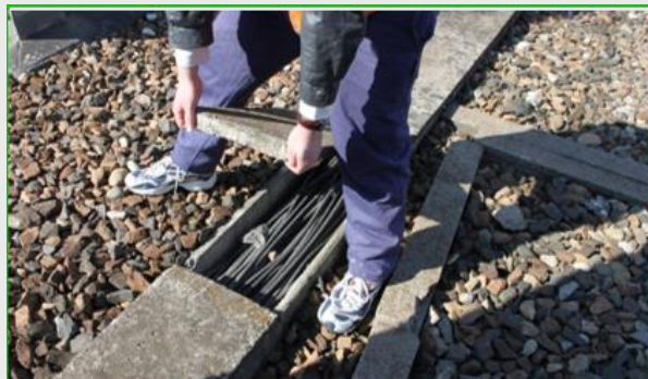
Télesurveillance des câbles de signalisation
